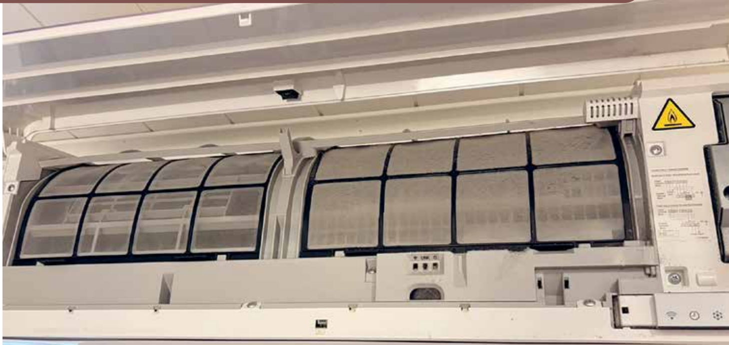
Ilmalämpöpumpun suodatin vasemmalla puhdistettu, oikealla puhdistamaton. Puhdistus kahden kuukauden välein.
