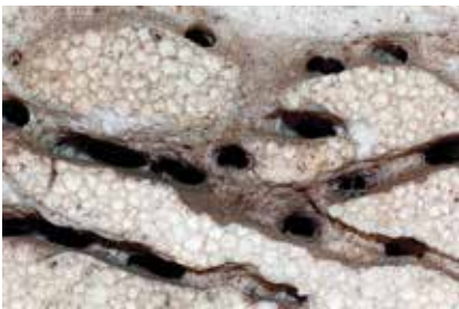
Hevosmuurahainen ja tuhon jäljet eristelevyssä.
