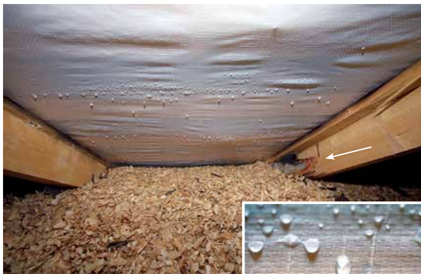
Huolehdi yläpohjan tuulettuvuudesta. Lahovauriota nuolen osoittamassa kohdassa.
