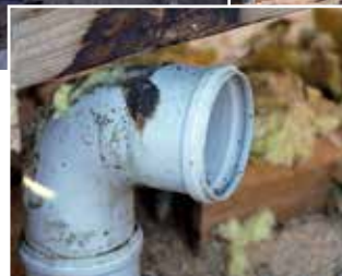
WC:n tuuletusputki on vietävä vesikalteen yläpuolelle.
