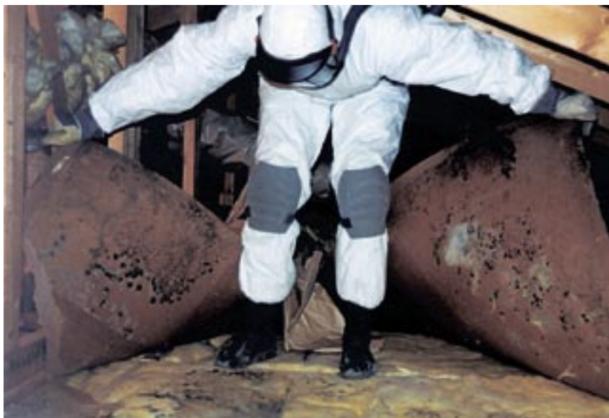
Kosteus on aiheuttanut homevaurioita lämpöeristeissä.
