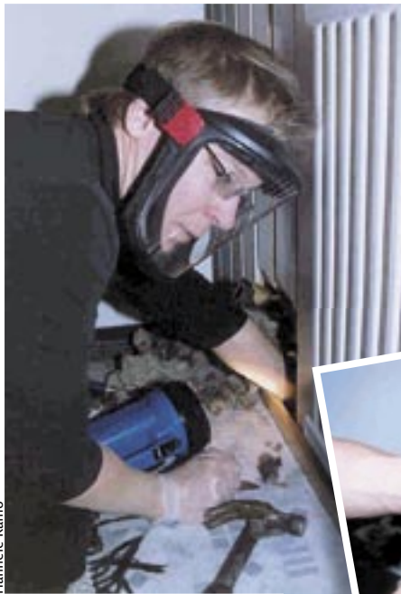
Juhani Pirinen tutkii alaohjauspuun kuntoa ja korkeusasemaa asiakkaan keittiössä. Omakotitalossa on valesokkeli ja alaohjauspuu on ympäröivän maanpinnan alapuolella.
