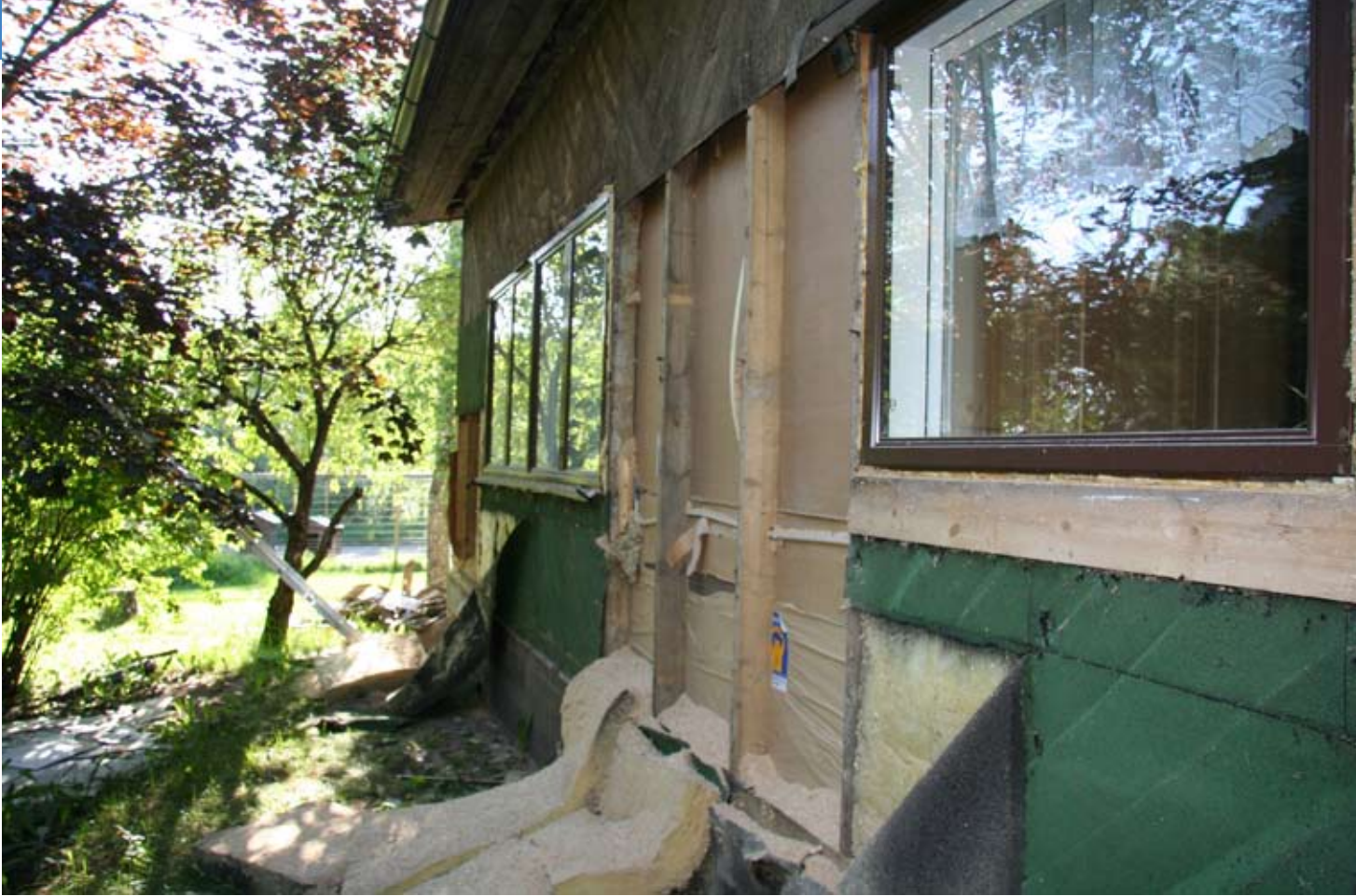
Taloa jouduttiin purkamaan joka puolelta, koska uusia vikoja ilmeni koko ajan.
